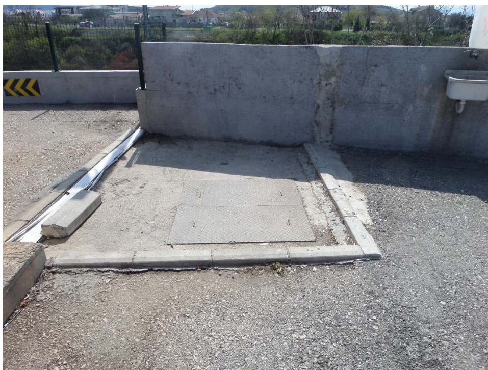
Slika 11. Šaht u kojem je smještan separator ulja i naftnih derivata
