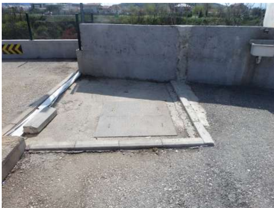
Slika 8. Šaht u kojem je smještan separator ulja i naftnih derivata
