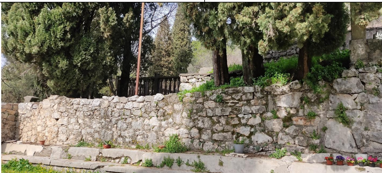
Ostećenja na sjevernom zidu porte
